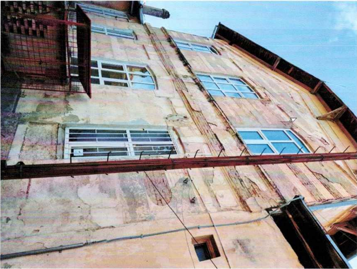
Figură 7 - Elemente degradate la fatada posterioară
